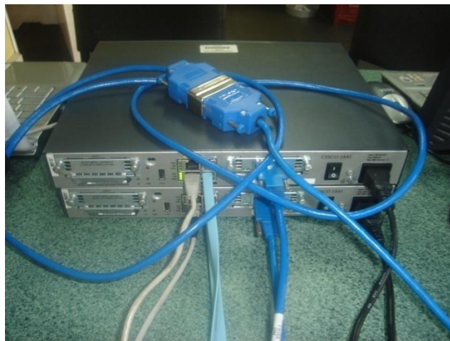
Figura 21 Conexión Router Cisco 1841
