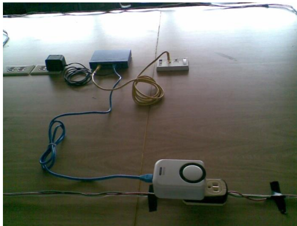
Figura 39. Red PLC ensamblada.
